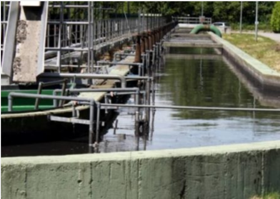
Il depuratore di Lonate Pozzolo
