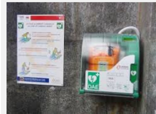
Il defibrillatore installato in Piazza Montegrappa
