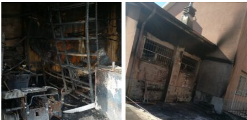
Locali distrutti dall'incendio
